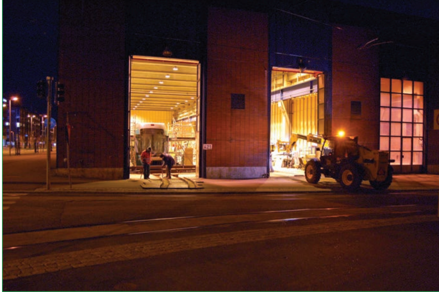
Klo 23.58. Tilapäisen raiteen kasaaminen on alkanut. Jalkakäytävälle on asetettu jigit, jotka auttavat raide-elementtien laskemisessa oikeaan asentoon.
