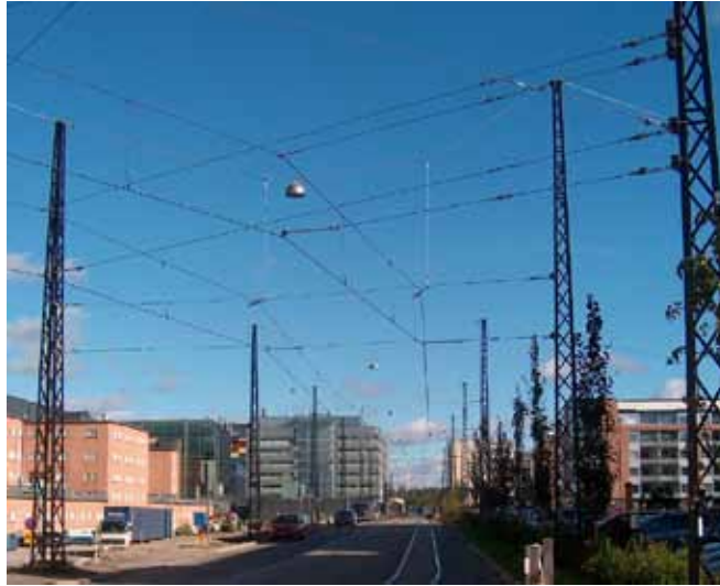
Arabianrannan radalle rakennettiin koe-mielessä painokiristetyt ajolankaripustukset vuonna 2004. Ripustettavien lankojen määrä on perinteiseen ripustukseen nähden yli kaksinkertainen, eikä menetelmä siten ole kaupunkikuvallisesti paras vaihtoehto. Kuva Arto Hellman 13.9.2005
